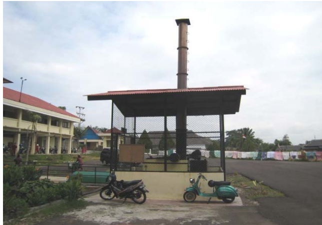
Gambar 4.7 Insenerator RSUD Rabain Muara Enim
